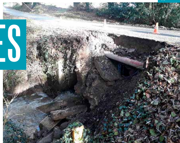
Effondrement de l'ouvrage en décembre 2020
