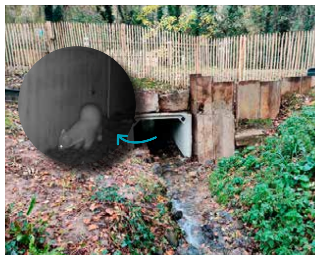
Passage du ruisseau sous la route après travaux : Pont cadre avec une banquette en gabion (cage de pierres) pour le passage de la faune terrestre même en crue. Hauteur d'eau de 15 cm en permanence dans l'ouvrage avec un pente nulle, permettant la libre circulation des poissons et des sédiments.
